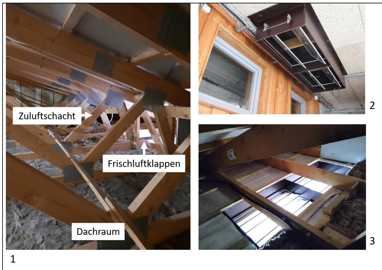
Abbildung 18: Darstellung des Dachraums über dem Versuchsabteil in den der Zuluftkanal und die Frischlufklappen führen (Bild 1). Außenansicht (Bild 2) und Innenansicht (Bild 3) der Frischlufklappen. ©Deeken
