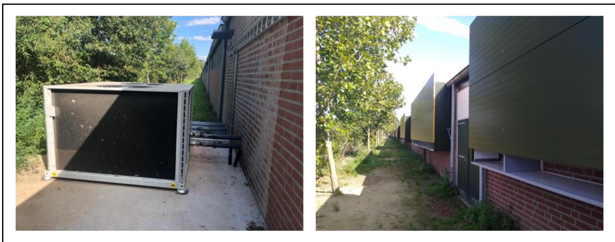
Abbildung 10: Links: Das Kühlaggregat sowie die Rohrleitungen für Zu- und Abfluss des Kaltwassers. © Büscher. Rechts: Die traufseitigen Frischlufteinlässe (inkl. Wasser-Luft-Wärmetauscher) des Stallgebäudes von Betrieb 2. ©Deeken
