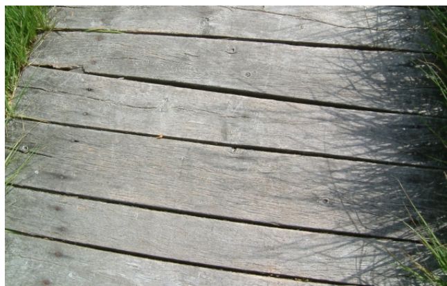
Abb. IV.2.AE3c Holzbohlenweg. Der natürliche Eindruck wird durch vergilbtes, ausgebleichenes Holz und die unregelmäßig zugeschnittenen Holzbohlen verstärkt.
