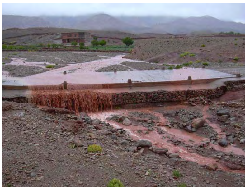
Abbildung 4.18 Überflutete Straße bei Alemdoun zwischen dem Ameskartal und Ifre während des großen Niederschlagsereignisses am 28.3.2004 (Foto: O. Schulz).
