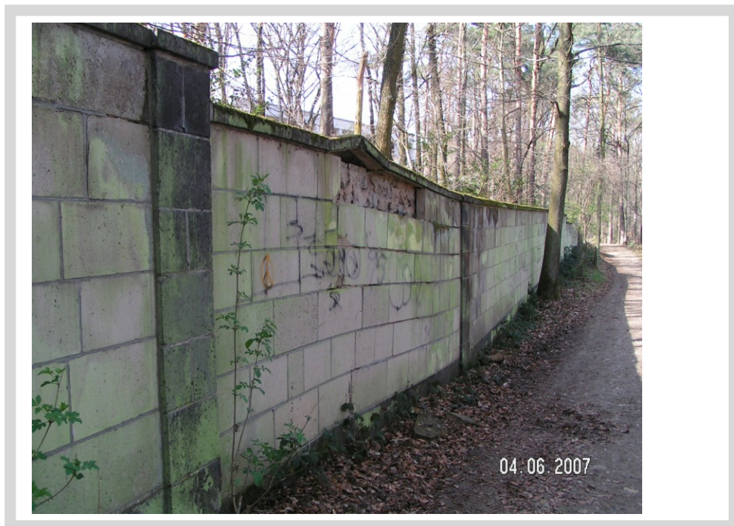
Abbildung 15.12: Versatz der Mauer am Klinikum der Universität Bonn auf der E-Seite des Venusbergs, Bonn aufgrund einer Rutschung, zu erkennen an den verformten parallelen Linien im Putz, den aufgestellten Deckplatten und dem abgebröckelten Putz darunter. Eigenes Foto.
