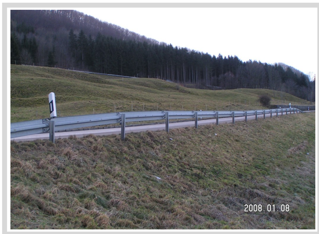
Abbildung 15.23. Rutschhang N Rechberg, Landstraße L 1159, verbogene Leitplanke. Eigenes Foto.
