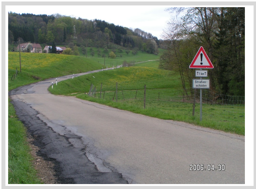
Abbildung 15.22: Verbreitete Straßenschäden S des Rechberges (hier bei Jackenhof). Eigenes Foto.
