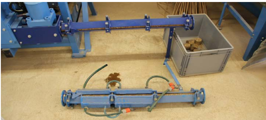
Abbildung 4-33: Passive (montiert) und aktive Abkühl- strecken der Brikettierung
