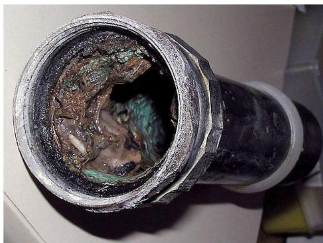
Abbildung 7: Abbildung eines Siphons mit Biofilm. © 1999-2012, MSU Center for Biofilm Engineering
