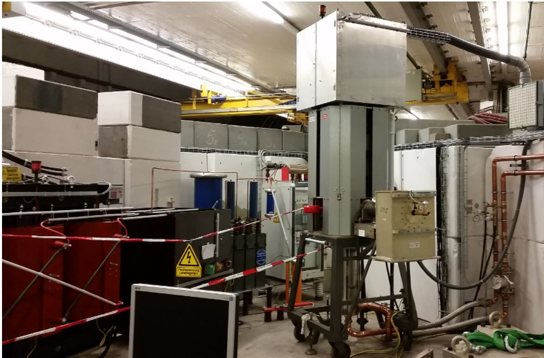
Abbildung 13.7: Klystronstrahl der neuen Hochfrequenzanlage im Aufbau mit (von links nach rechts) Hochspannungstransformator, Gleichrichter, Siebkette und Klystron.
