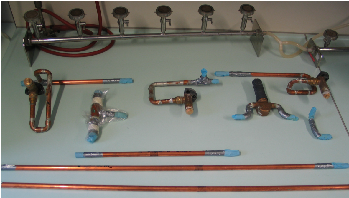
Abb. 10: Ausgebaute Teilstücke aus dem Teilstrang zur tiefergehenden Untersuchung
