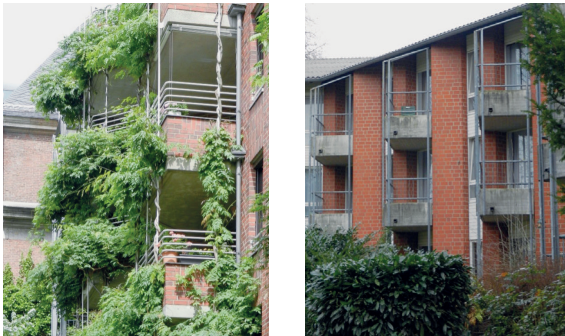
5.3 Abb. 40 geschossübergreifende Rankhilfen im Vergleich, St.-Vincenz-Haus Köln (R) und Haus Greefsgarten Viersen (L), Aufnahme 2012
