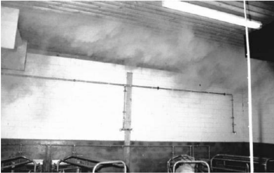
Abbildung 12: Strahl­lüftung in einem Abferkelabteil (DLG, 2006)
