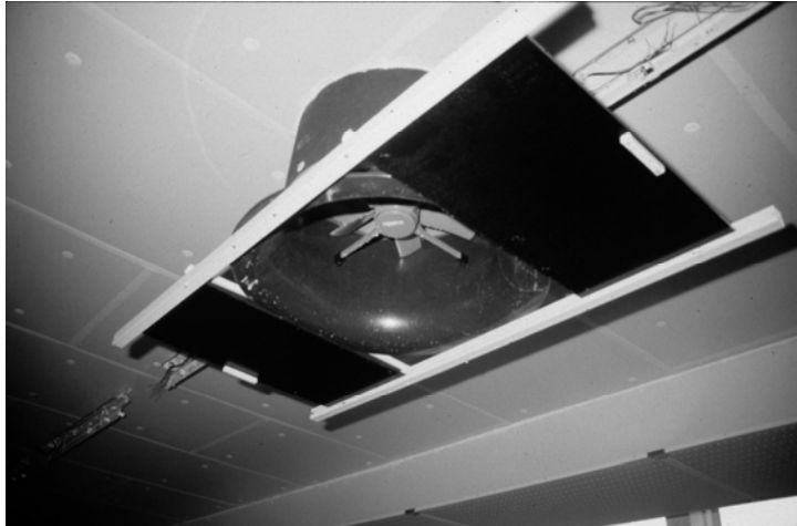
Abbildung 16: Oberflurabsaugung mit Absperrschiebern
