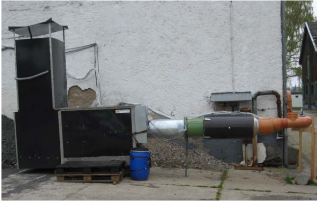
Abb. 17: Abluftwäscher zur Abluftreinigung hinter dem Versuchsabteil
