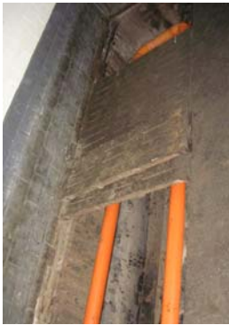
Abb. 13: Unterflurabsaugung über KG-Rohre im Versuchsabteil
