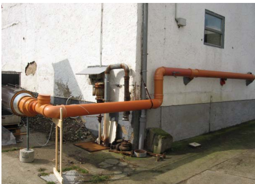
Abb.15: Unterflurabsaugung im Außenbereich bis zum Wäscher
