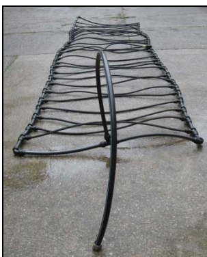
Abb. 10: Belüftungsgitter der Praxisanlage
