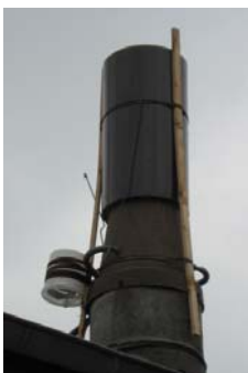
Abb. 19: Messventilator an der Oberflurabsaugung zur Luftvolumenstrombestimmung
