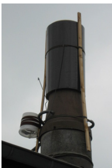
Abb. 19: Messventilator an der Oberflurabsaugung beider Abteile zur Luftvolumenstrombestimmung
