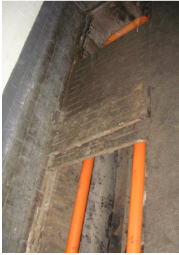
Abb. 13: Unterflurabsaugung über KG-Rohre im Versuchsabteil
