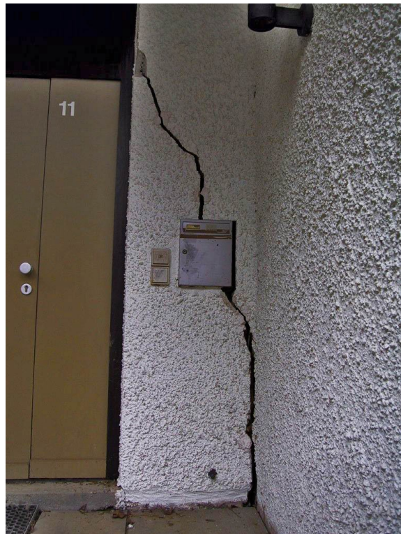
Abbildung 3: Riss in einem Haus in Mössingen-Öschingen
