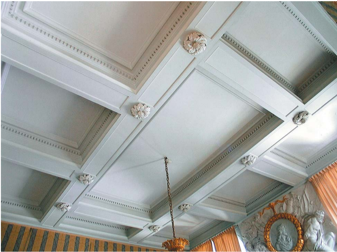
152. Schloss Maisons, chambre des captifs, Decke
