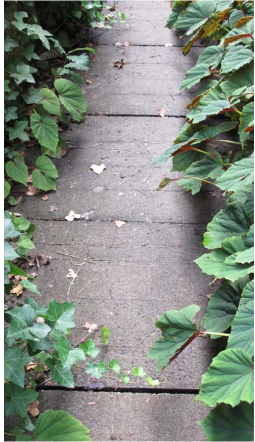
Abb. 348 Villa Ottolenghi, unbefestigte Bodenplatten der Calle
